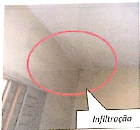
Foto - 17 | Dormitório frente do imóvel Detalhes para reparação
