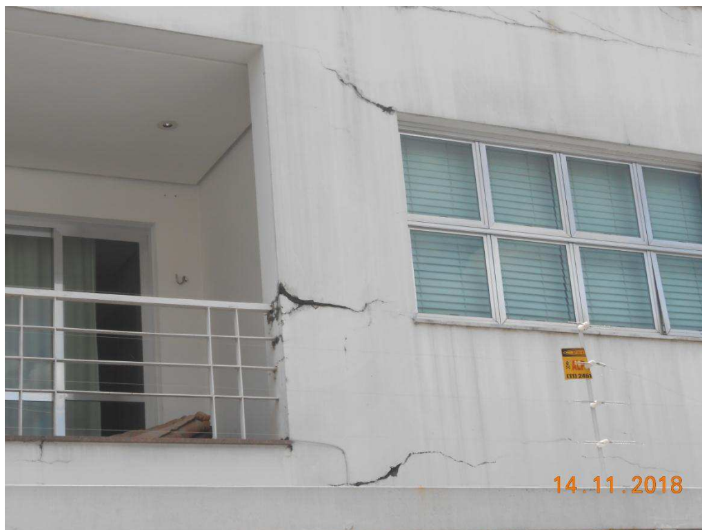
Foto 6: Rachaduras na fachada
