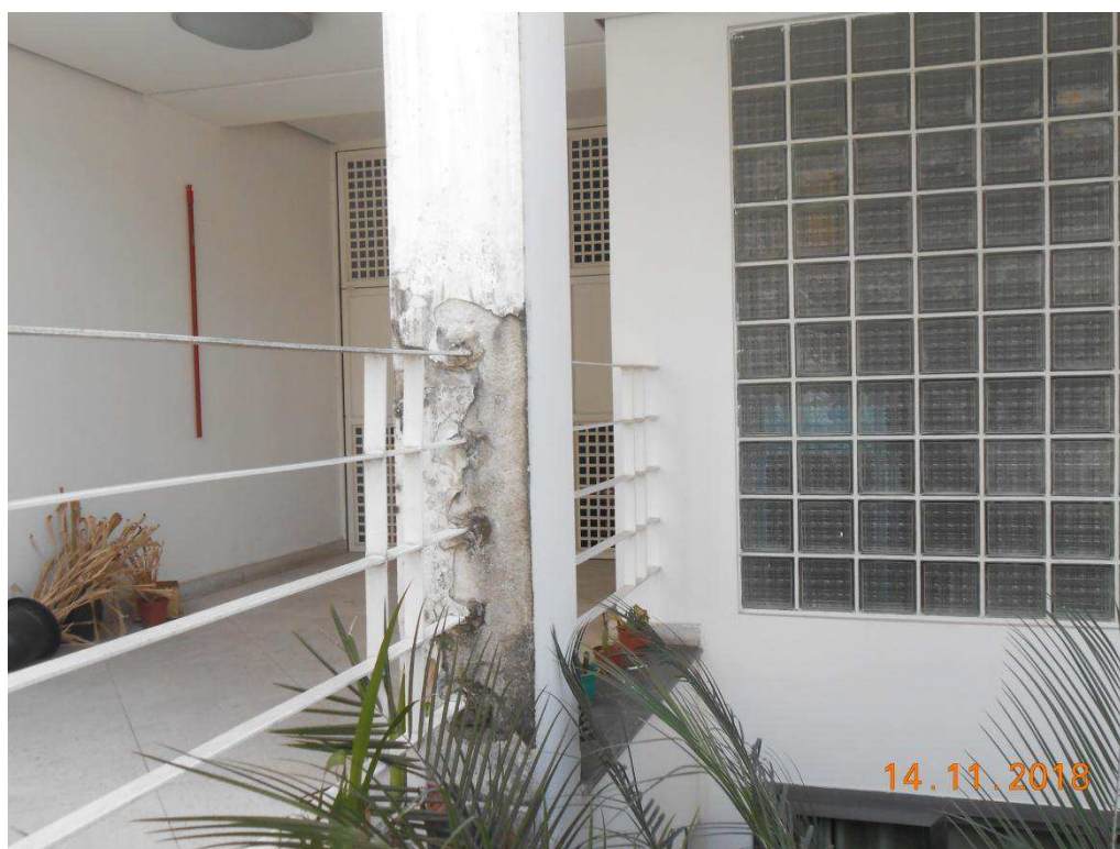
Foto 7: Desgaste da pintura
