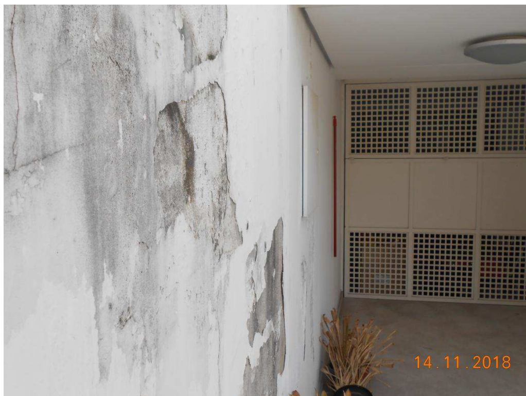
Foto 8: Desgaste da pintura
