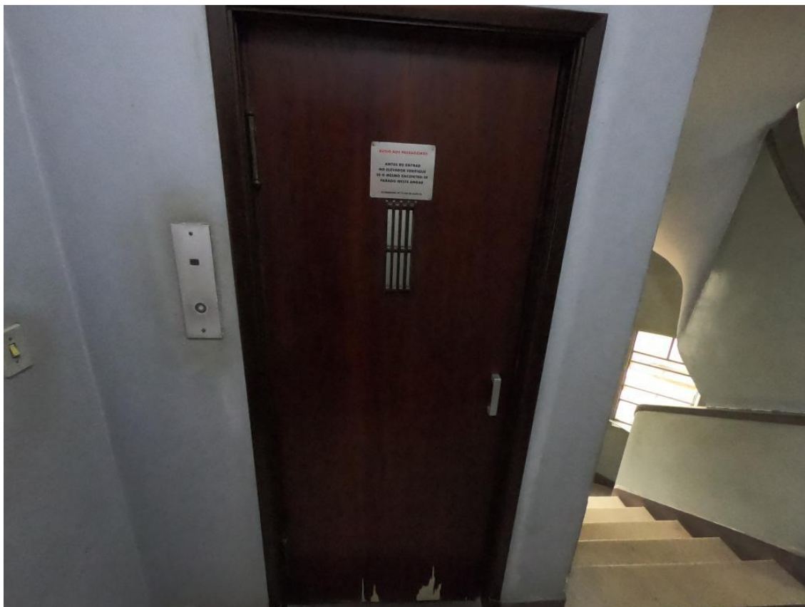
Figura 144. Porta do elevador.
