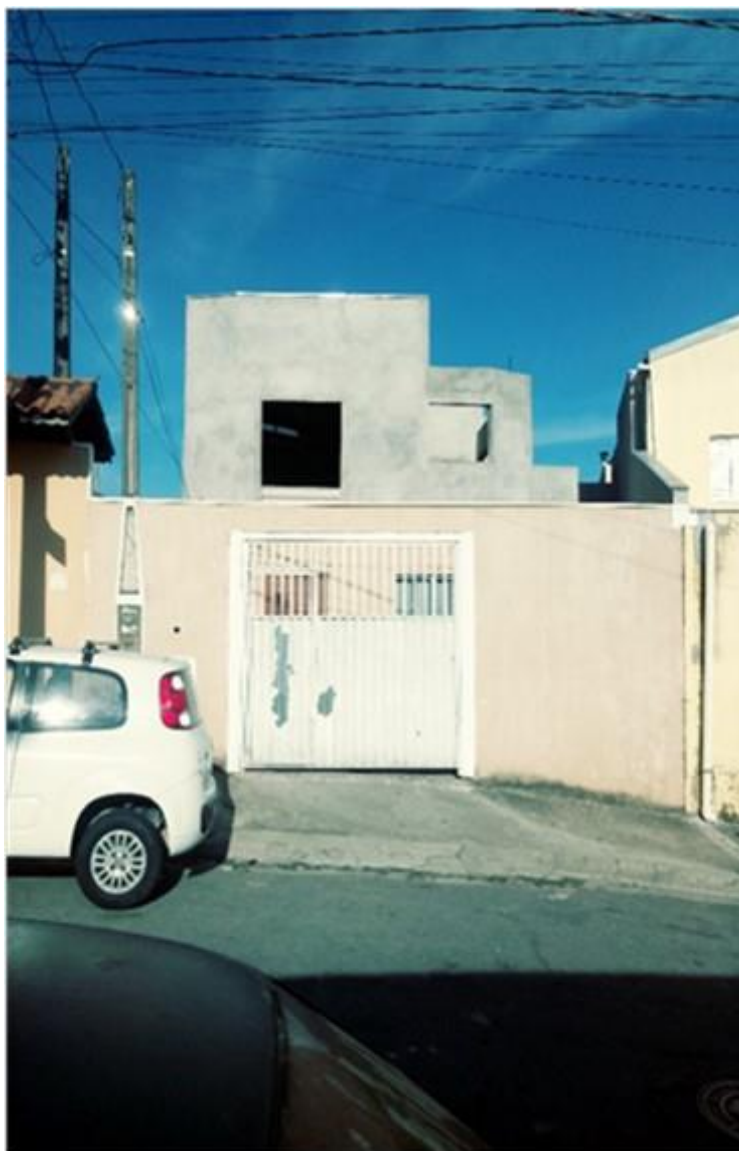
Foto nº 03: Fachada do imóvel em estudo sob nº 30 da Rua Diácono Egydio Marreti.
