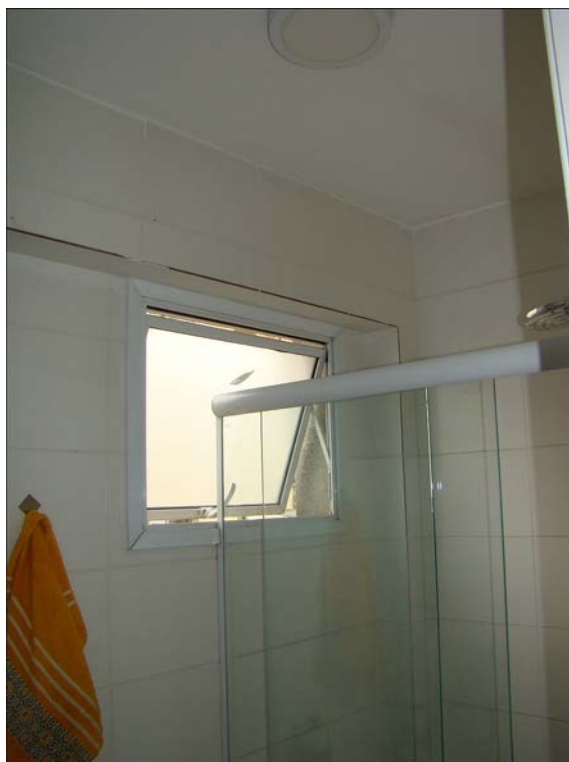
A foto ilustra o Banheiro do apartamento nº 101, no 10º andar do Edifício Morada Bela Vista (Condomínio Atmosphaera).
