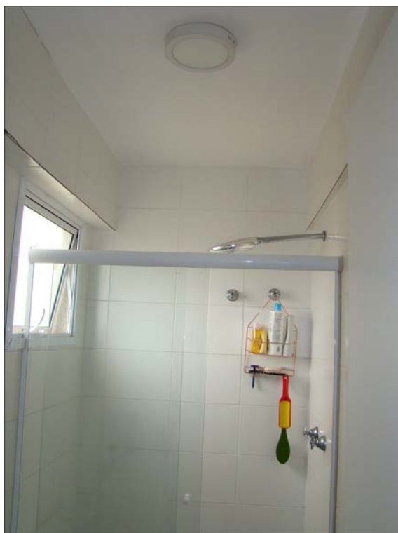
A foto ilustra o Banheiro no Dormitório 01 do apartamento nº 101, no 10º andar do Edifício Morada Bela Vista (Condomínio Atmosphaera).
