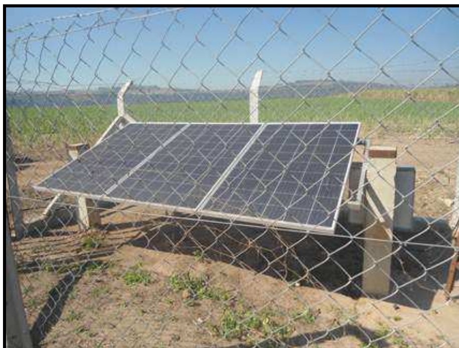
PLACAS SOLARES – POÇO ARTESIANO
