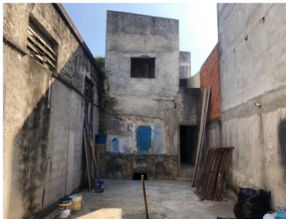
FOTO 27 - Vista parcial ÁREA LATERAL ao GALPÃO parede azul, paredes com marcas e umidade
