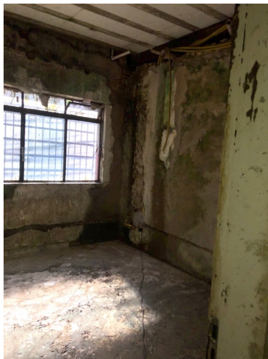
FOTO 41 - Vista parcial SALA FRENTE, paredes com marcas e umidade
