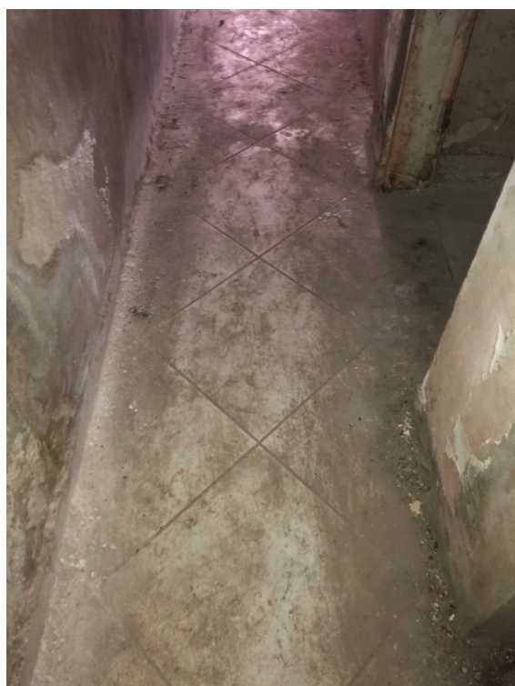
FOTO 44 - Vista piso CORREDOR INTERNO, paredes com marcas e umidade
