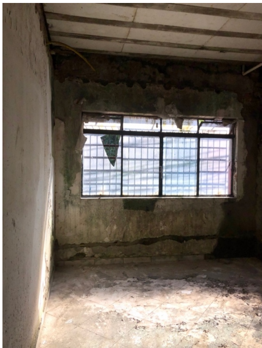
FOTO 40 - Vista parcial SALA FRENTE com vidros quebrados, paredes com marcas e umidade
