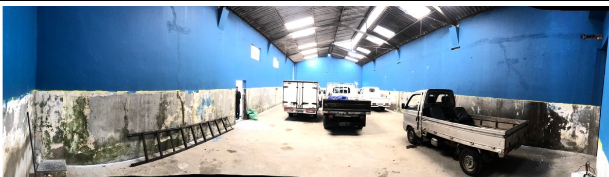
FOTO 25 - Vista panorâmica do GALPÃO parede azul, paredes parte inferior com marcas e umidade
