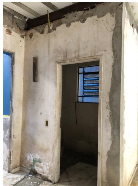
FOTO 16 - Vista HALL DE ENTRADA – lado direito, ausência de portas internas
