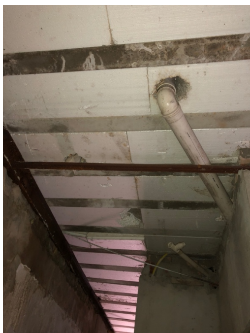
FOTO 42 - Vista teto CORREDOR INTERNO, forro reformado, tubos pvc, paredes com marcas e umidade
