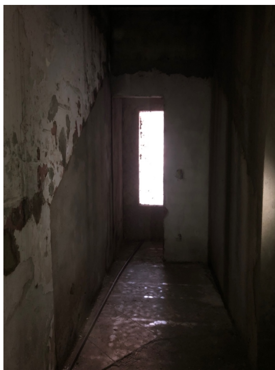
FOTO 45 - Vista CORREDOR INTERNO, paredes com marcas e umidade
