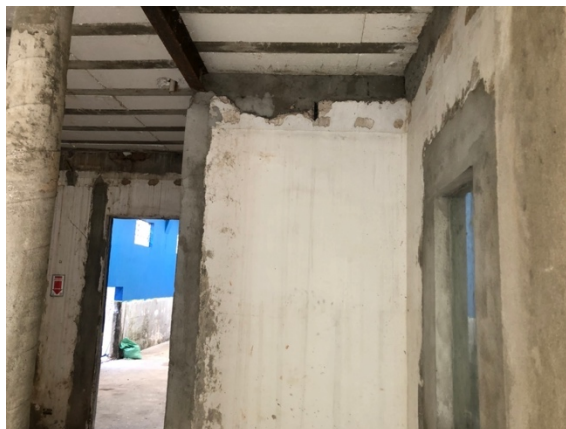
FOTO 12 - Vista HALL DE ENTRADA a partir da escada interna, ao fundo GALPÃO parede azul, ausência de portas internas
