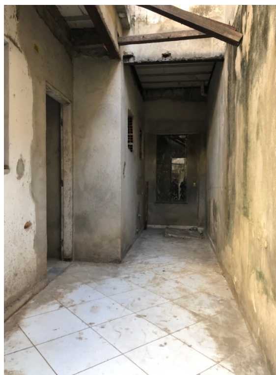
FOTO 32 - Vista a partir da ÁREA LATERAL para Corredor que leva à ÁREA INTERNA, paredes com marcas e umidade
