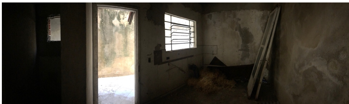
FOTO 37 - Vista panorâmica ÁREA INTERNA, porta que leva ao Corredor, paredes com marcas e umidade
