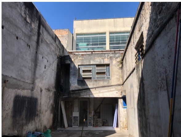
FOTO 26 - Vista parcial ÁREA LATERAL ao GALPÃO parede azul, janelas ao fundo com vidros quebrados, paredes com marcas e umidade
