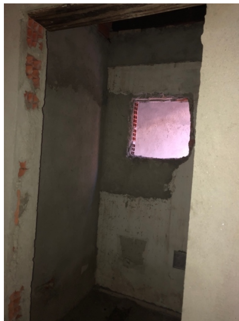
FOTO 36 - Vista parcial ÁREA INTERNA, uma das salas internas, paredes com marcas e umidade
