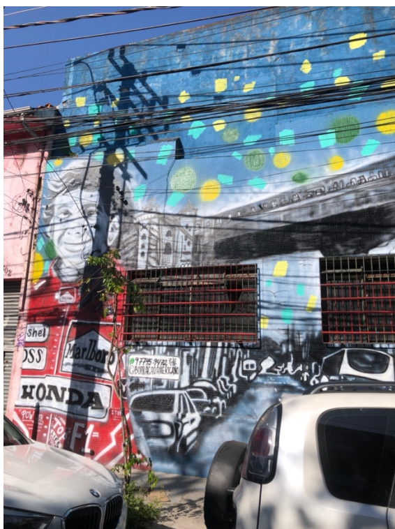
FOTO 7 - Vista parcial FACHADA externa – janelas com grades e vidros quebrados
