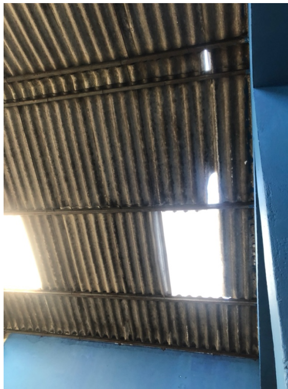
FOTO 24 - Vista teto do GALPÃO parede azul – telhas danificadas
