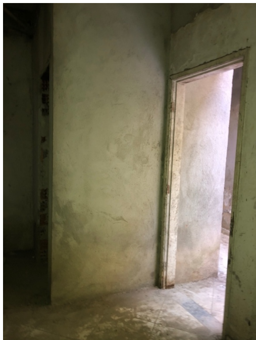
FOTO 35 - Vista parcial ÁREA INTERNA, porta que leva ao Corredor, paredes com marcas e umidade
