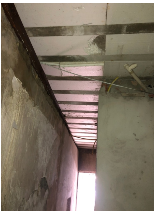
FOTO 43 - Vista teto CORREDOR INTERNO, forro reformado, tubos pvc, paredes com marcas e umidade
