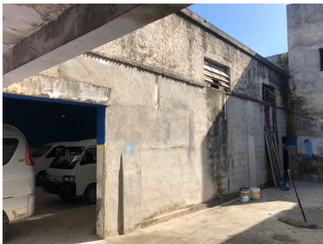
FOTO 28 - Vista parcial ÁREA LATERAL ao GALPÃO parede azul, janelas laterais com vidros quebrados, paredes com marcas e umidade
