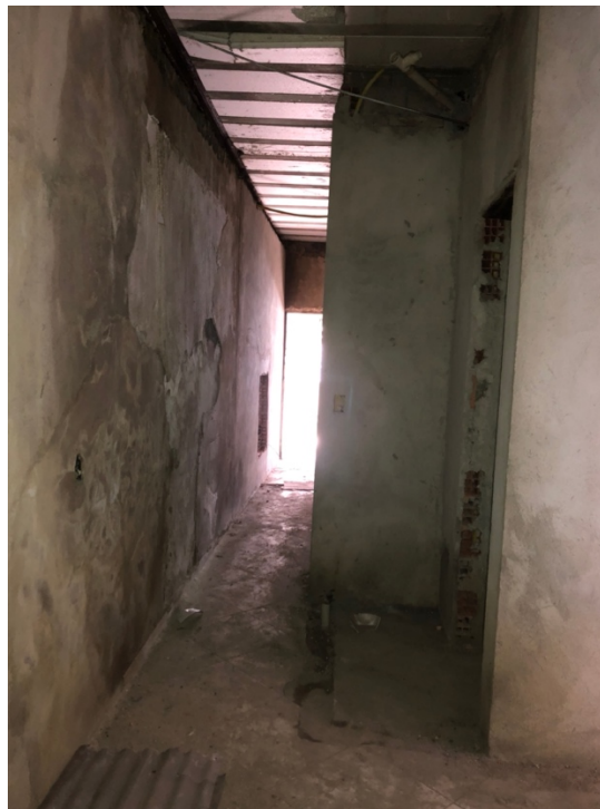
FOTO 34 - Vista a partir da ÁREA INTERNA, ÁREA LATERAL ao fundo, paredes com marcas e umidade
