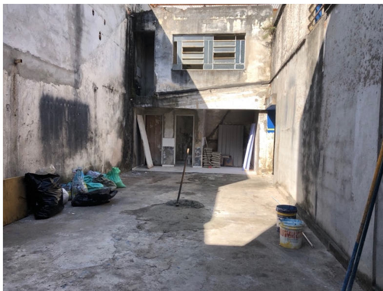
FOTO 30 - Vista parcial ÁREA LATERAL ao GALPÃO parede azul, janelas ao fundo com vidros quebrados, paredes com marcas e umidade
