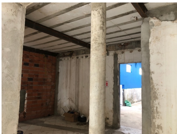
FOTO 13 - Vista HALL DE ENTRADA após subir a escada da entrada, ao fundo GALPÃO parede azul, ausência de portas internas
