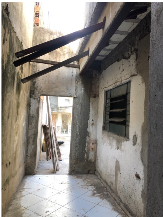
FOTO 33 - Vista a partir do Corredor, ÁREA LATERAL ao fundo, paredes com marcas e umidade
