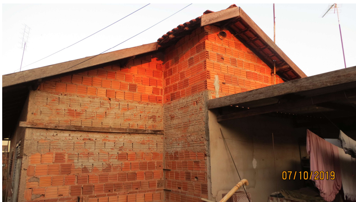
Figura 3 – Parte residencial principal. Revestimento das alvenarias da lateral direita e dos fundos não executado.
