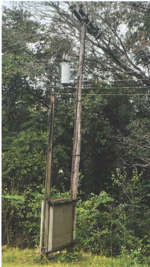
Fotografia 14. Poste do medidor e poste do transformador inadequado ao uso.
