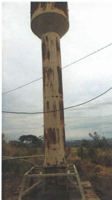
Fotografia 1. Reservatório de 5000 litros com vazamento
