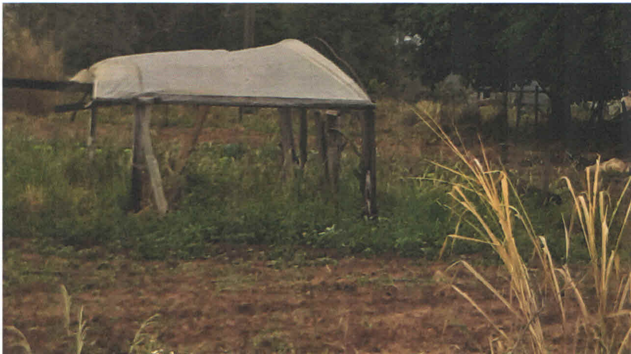
Fotografia 9. Vista externa de estufa desmoronada.
