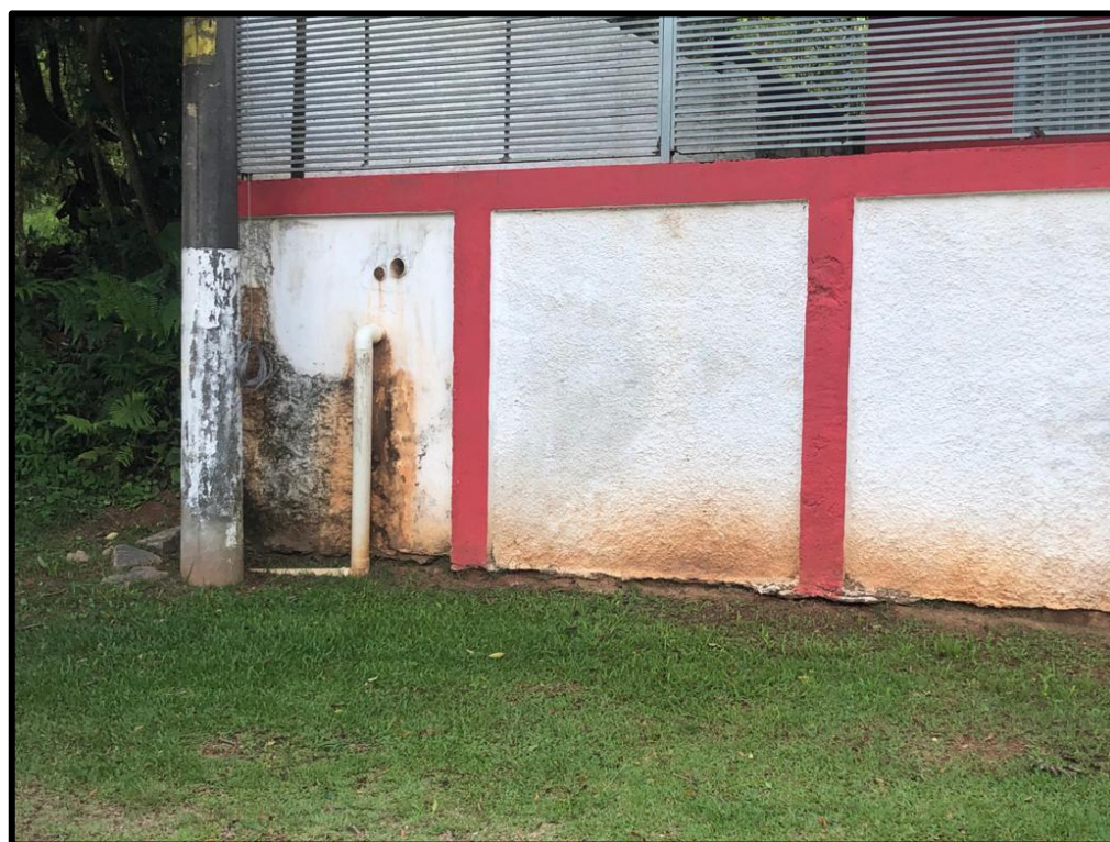
Foto 4: Vista do muro de divisa - vazamento
