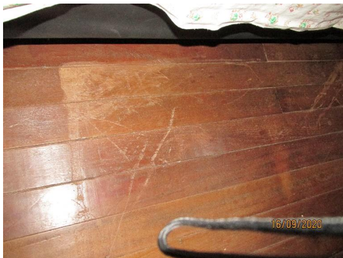
Desgaste Piso/Dormitório I
