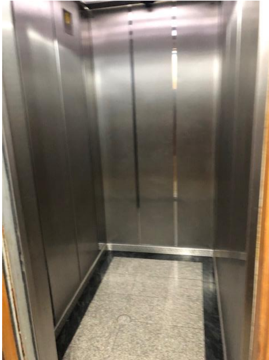
Detalhe da cabine do elevador.
