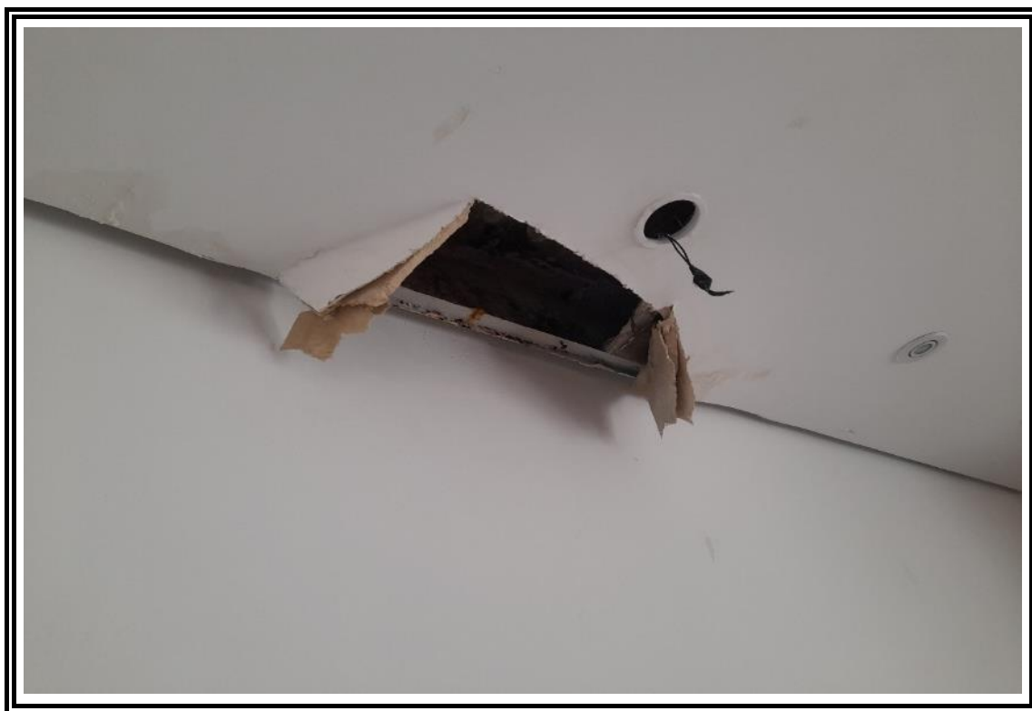
Foto nº 11: Detalhe de danos causados por infiltração no forro da sala de estar
