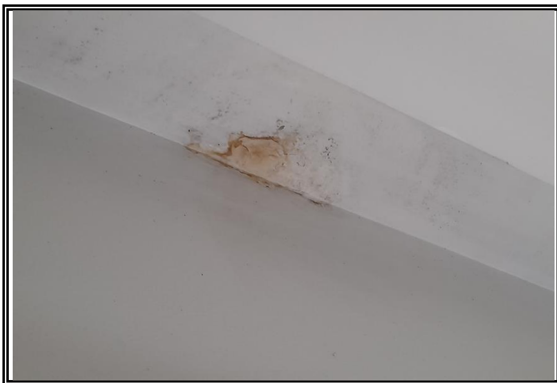
Foto nº 21: Detalhe de danos causados por infiltração no forro do dormitório 01
