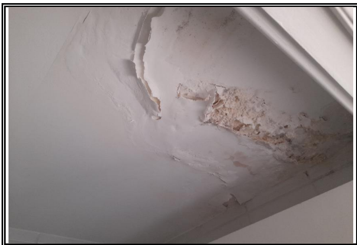
Foto nº 19: Detalhe de danos causados por infiltração no forro do banheiro de serviço
