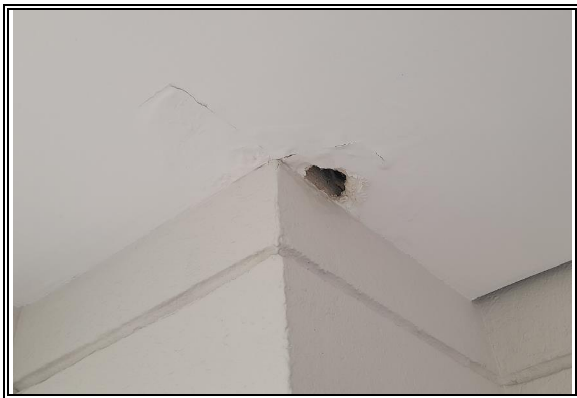
Foto nº 12: Detalhe de danos causados por infiltração no forro da sacada/varanda gourmet
