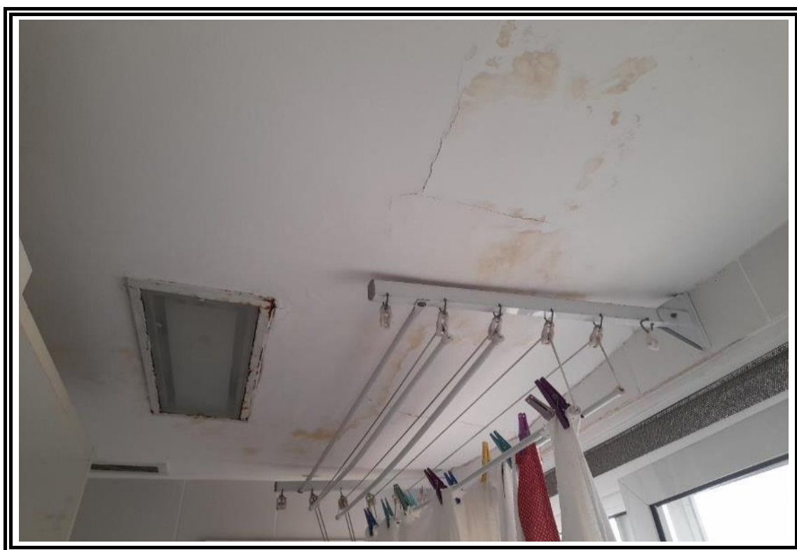
Foto nº 17: Detalhe de danos causados por infiltração no forro da área de serviço
