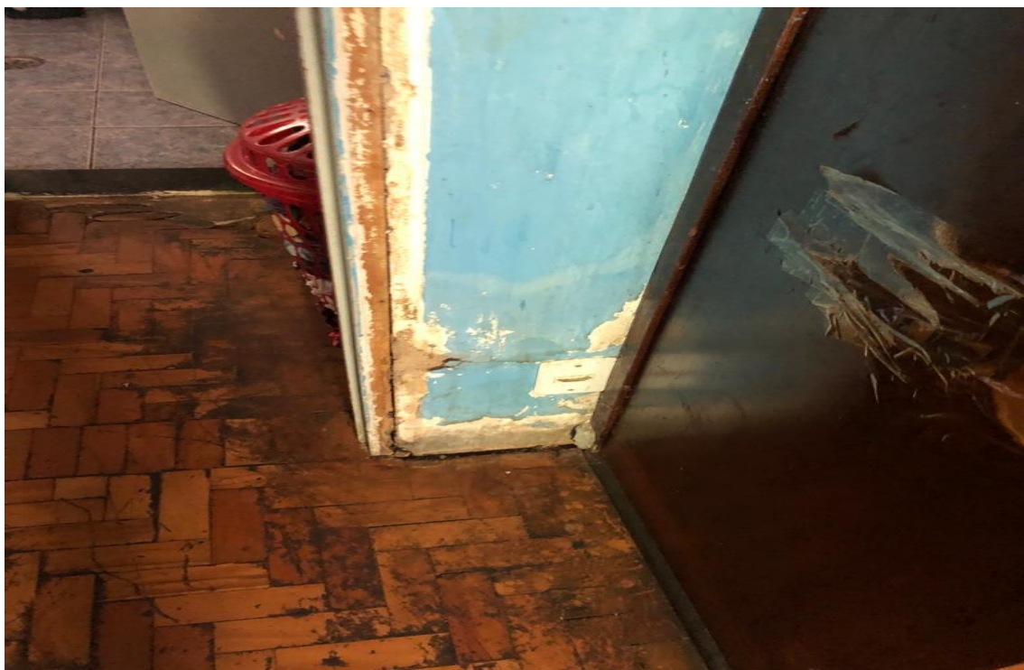
Situação atual – sem manutenção
