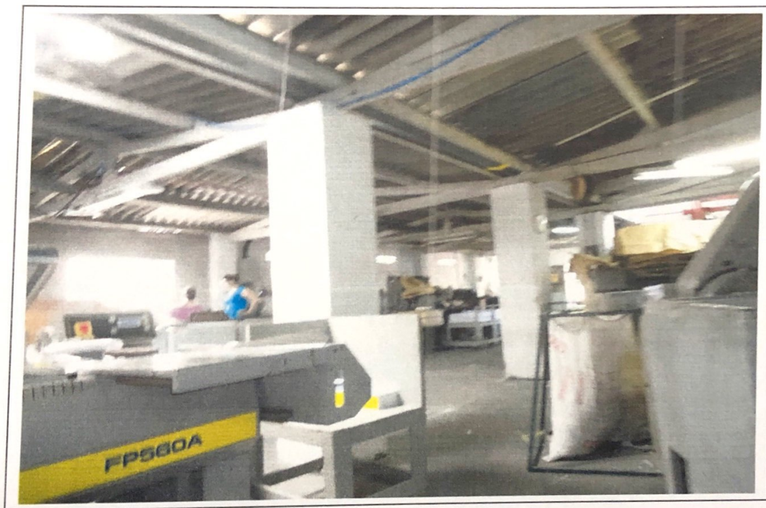
Foto 17: Vista do setor de impressão da gráfica a qual funciona no interior do imóvel e é coberta com telhas de fibrocimento.
