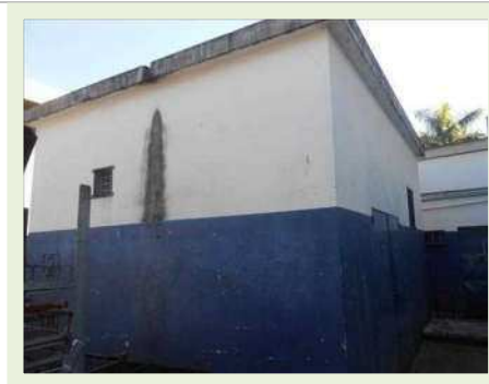
Cabine de Força 2
