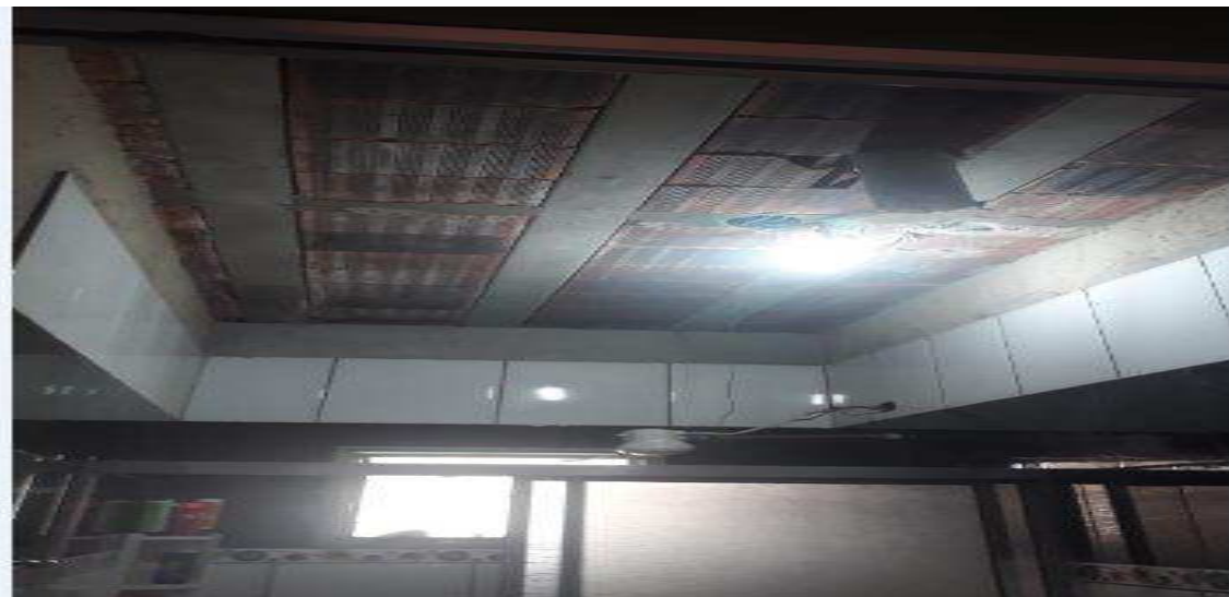
Teto do banheiro
