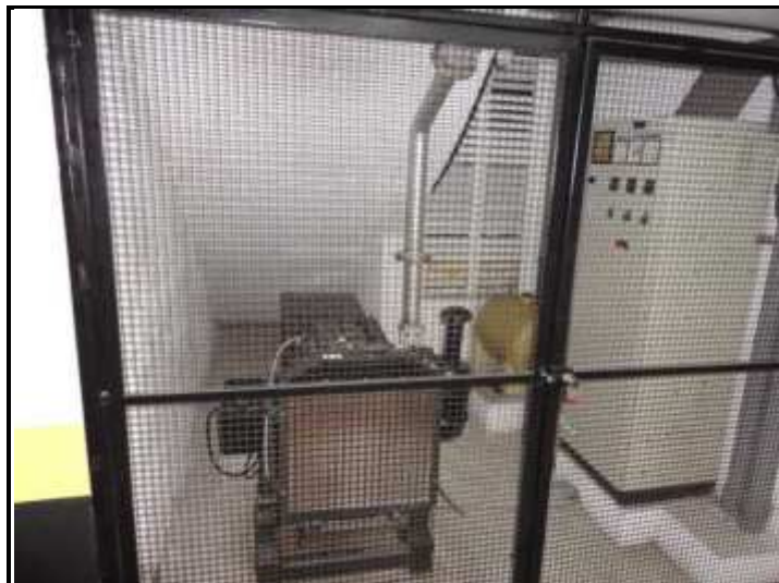
Foto 41: Subsolo: conjunto motor/gerador de energia elétrica de emergência
