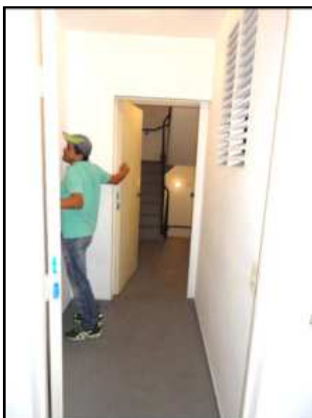
Foto 28: Saída de emergência: ante câmara para exaustão e escada de emergência
