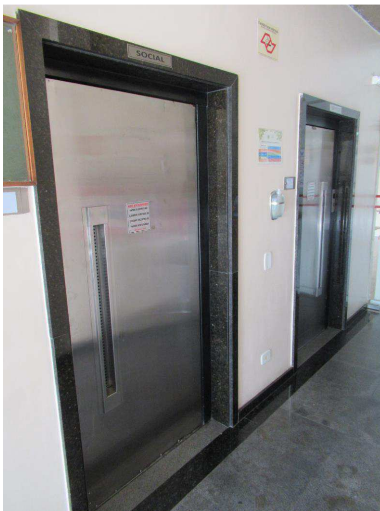
Foto nº. 19 – Vista dos elevadores localizado no hall social.
