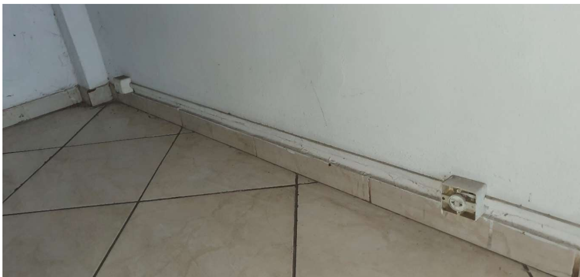
FOTO 15: SALA TÉRREO, FIAÇÃO COM CONDUÍTES EXTERNOS E TOMADAS FORA DE PADRÃO.
