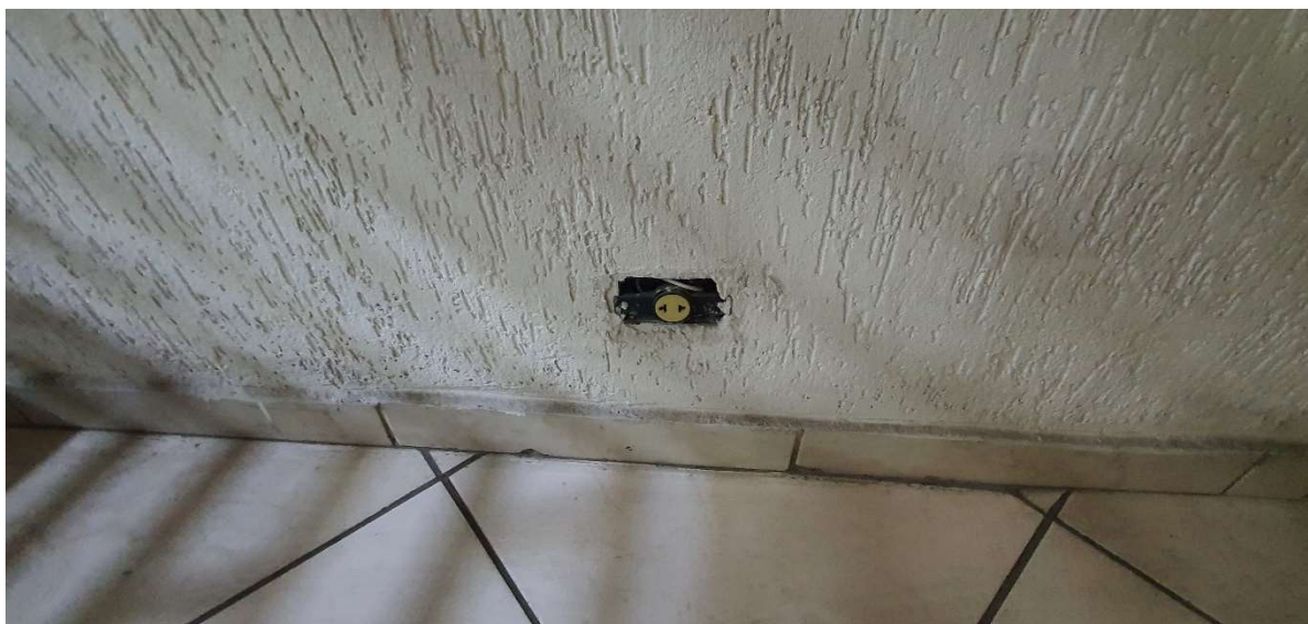
FOTO 14: SALA TÉRREO, PADRÃO DE TOMADA ANTIGO E FALTA ESPELHO DE ACABAMENTO.
