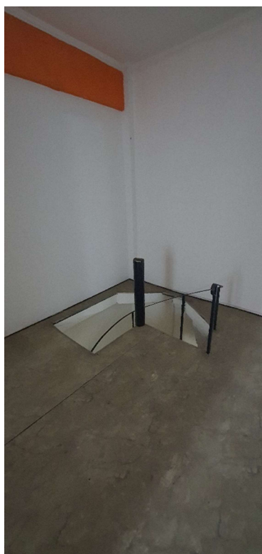
FOTO 20: SALA MEZANINO, VISTA DA CHEGADA DA ESCADA, FALTA PROTEÇÃO
