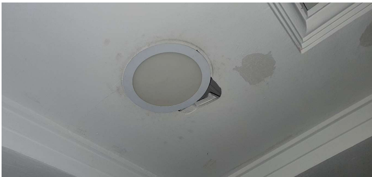
FOTO 17: SALA TÉRREO, FORRO DE GESSO DANIFICADO.
