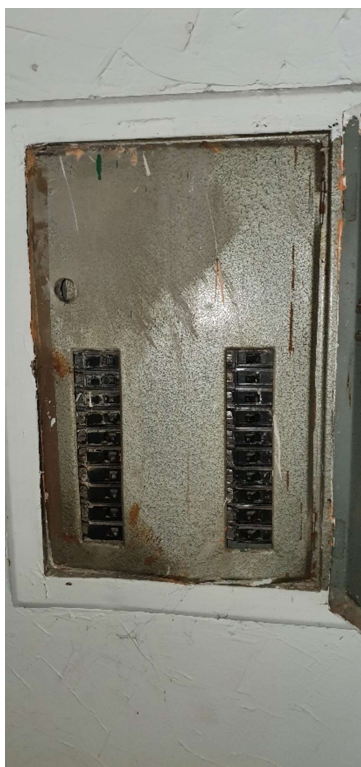
FOTO 18: SALA TÉRREO, QUADRO ELÉTRICO.
