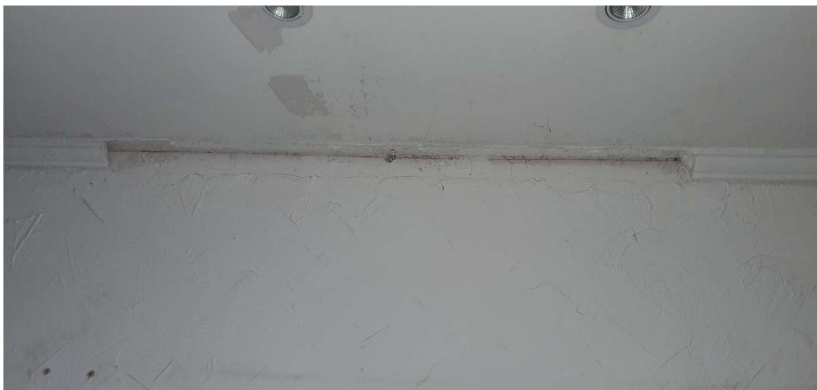
FOTO 16: SALA TÉRREO, MOLDURA DANIFICADA E TETO COM PROBLEMA DE PINTURA.
