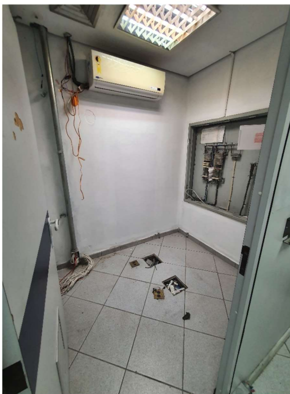
FOTO 07 – SALA COM QUADRO DE DISTRIBUIÇÃO
