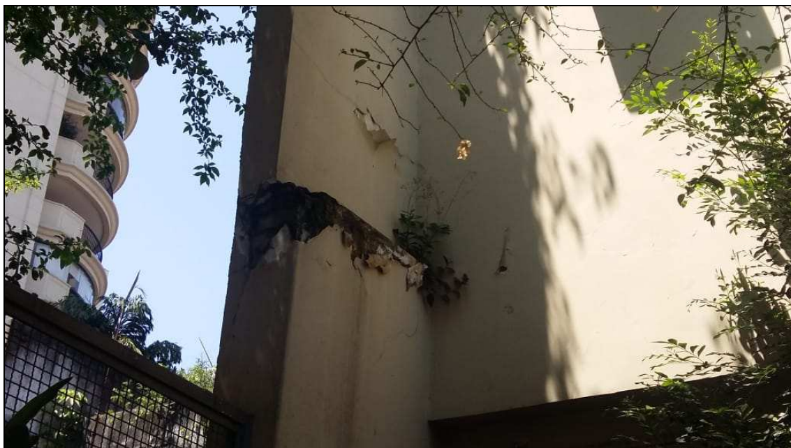
Figura 7 – Vegetação crescendo por entre a estrutura
