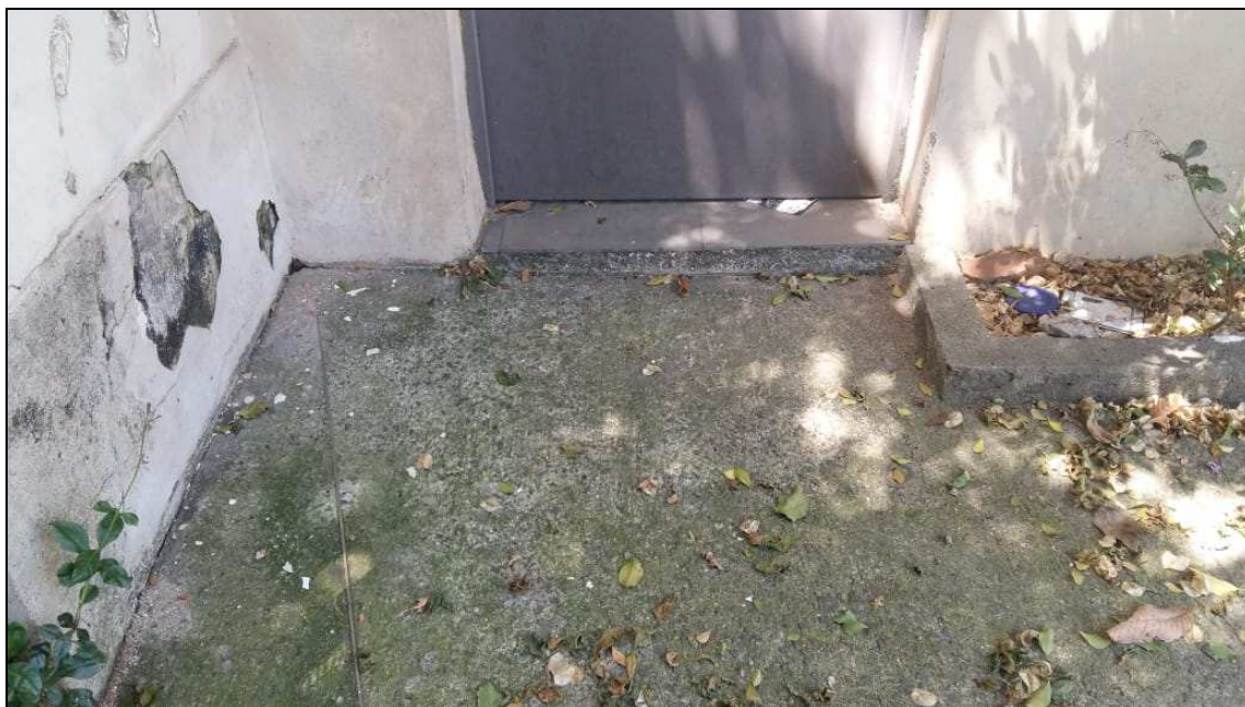
Figura 6 – Estado de abandono
