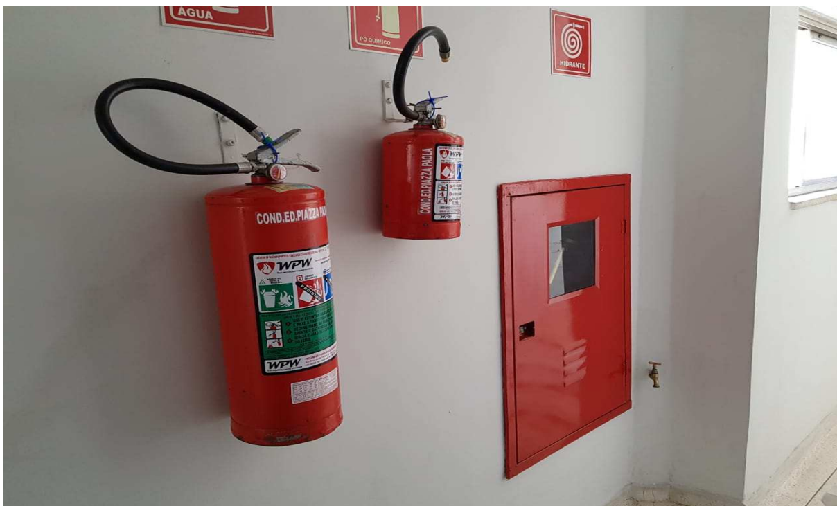
Foto 9 – Equipamentos de combate a incêndios do 12º andar
