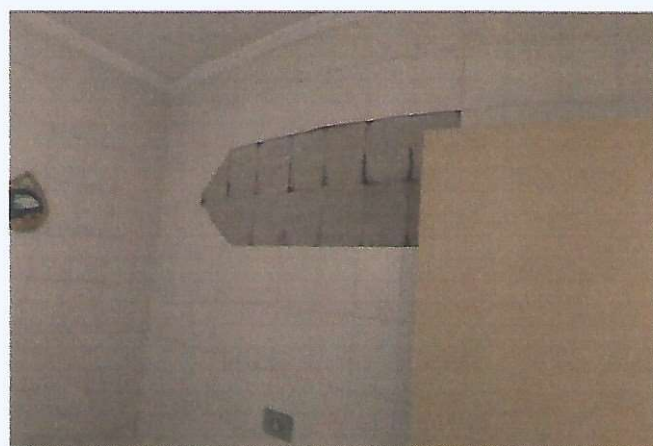
Figura 19 – Detalhe azulejos faltantes e estufados, COZINHA.
