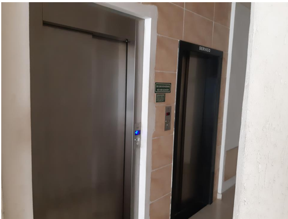
Elevadores “social” e de “serviço”
