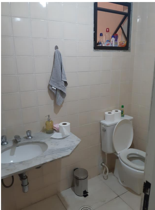
Vista do banheiro social. Não há box no chuveiro
