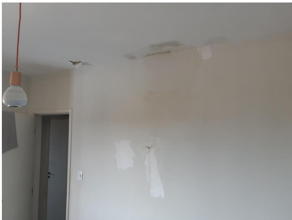
Parede do dormitório da suíte: sinais de infiltração na parede que divisa com o banheiro social
