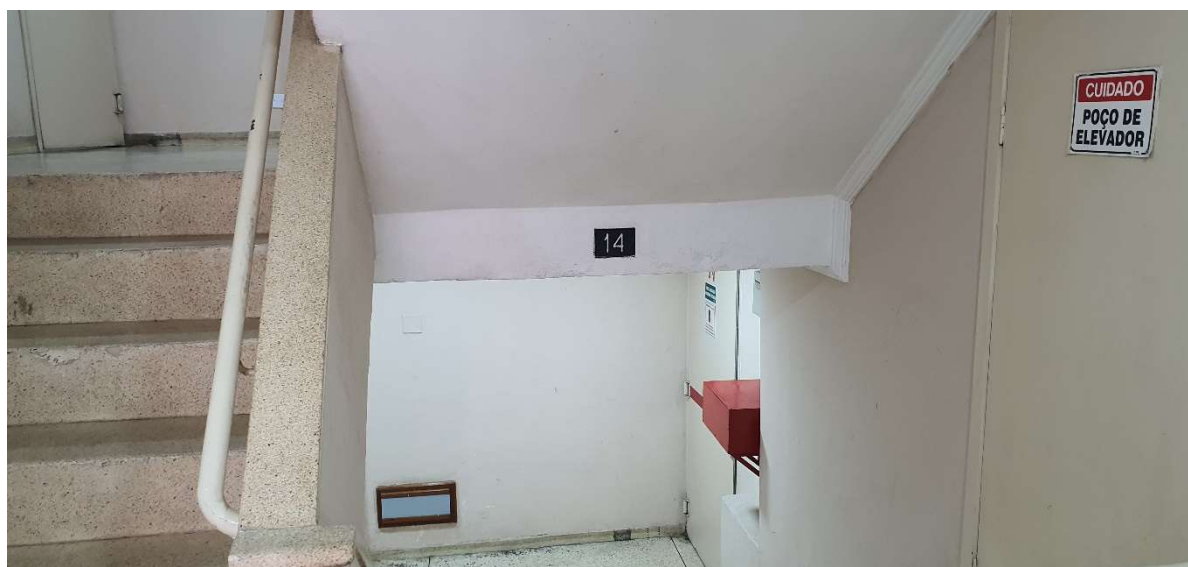
FOTO 13: O HALL DO ELEVADOR FICA NO MEIO DO PAVIMENTO ENTRE O 14º E 15º PAV.
