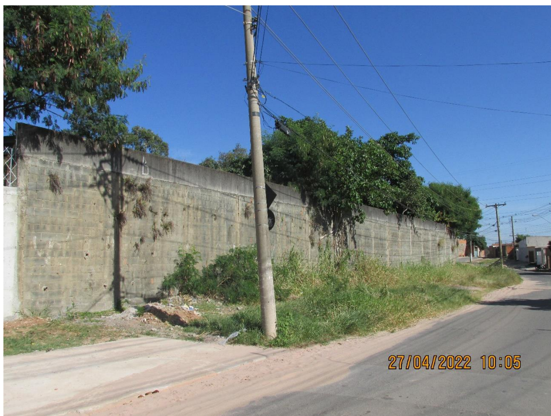
Fachada Imóvel Periciando
