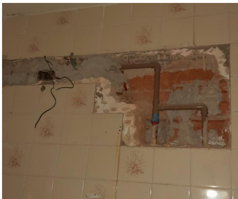
Outro reparo de hidráulica não concluído e azulejos removidos.
