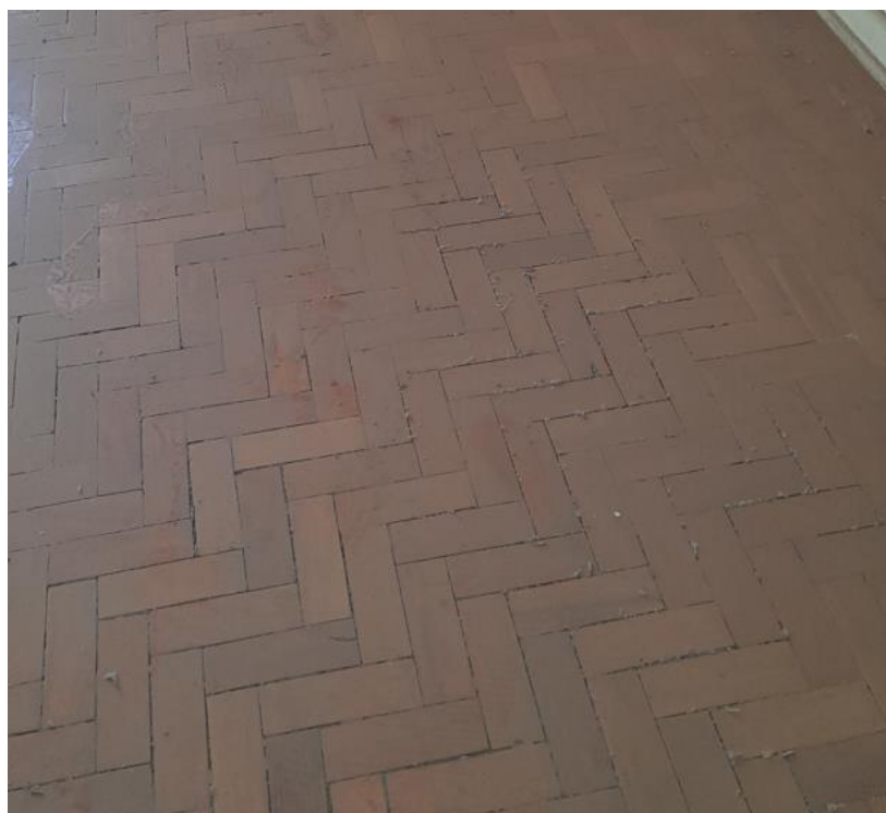
Piso do dormitório em tacos de madeira.
