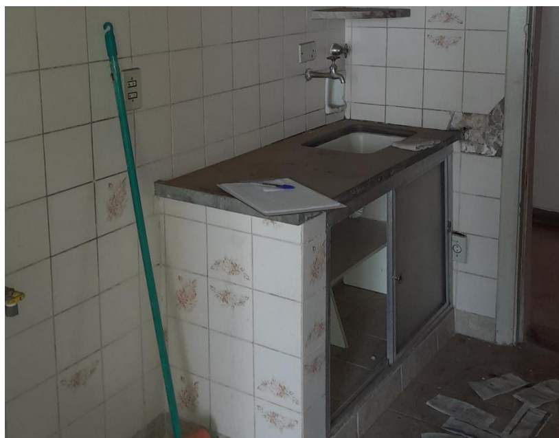
Bancada da cozinha e azulejo danificado ao nível da bancada.
