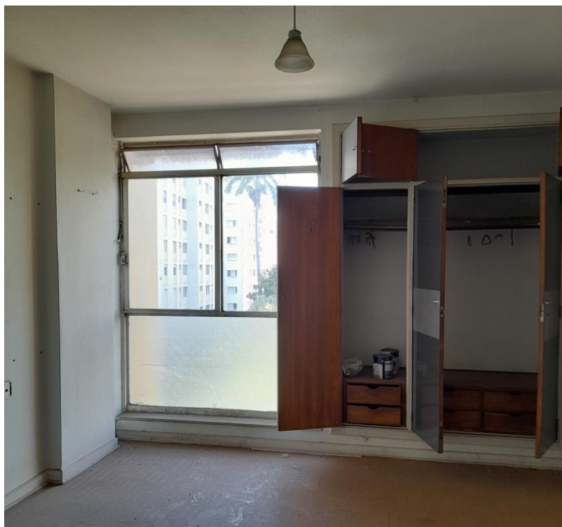
Vista interna do apartamento, com detalhe para janela envidraçada e vidro trincado
