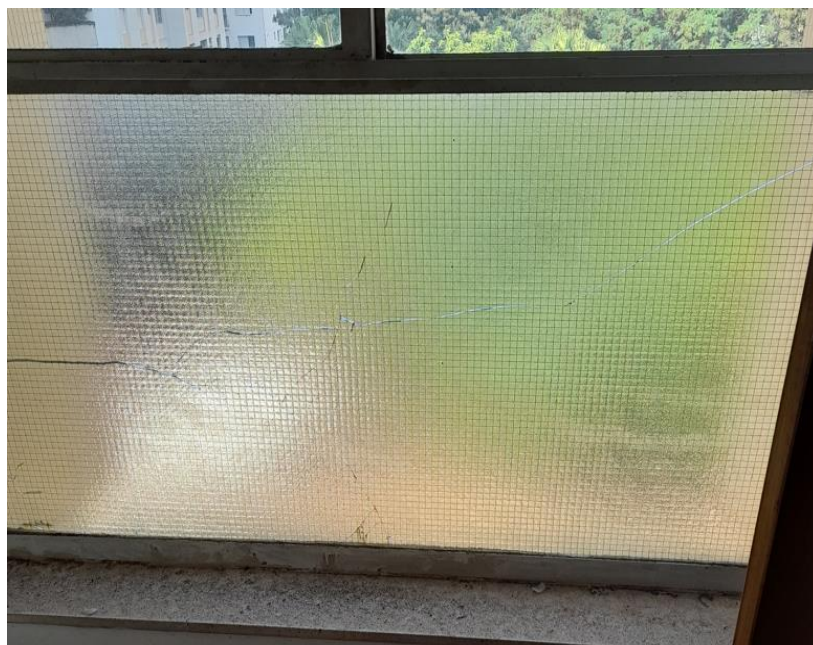
Vidro trincado da janela.
